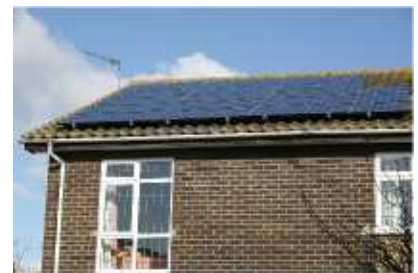
FIGURE 6.5. Le solaire photovoltaïque : les données proviennent d'un ensemble de 25 \text{ m}^2 de panneaux installés dans le Cambridgeshire en 2006. La puissance-crête fournie par cet ensemble est d'environ 4 kW. La puissance moyenne sur l'ensemble de l'année est de 12 kWh par jour. Ce qui fait 20 W par mètre carré de panneau.
