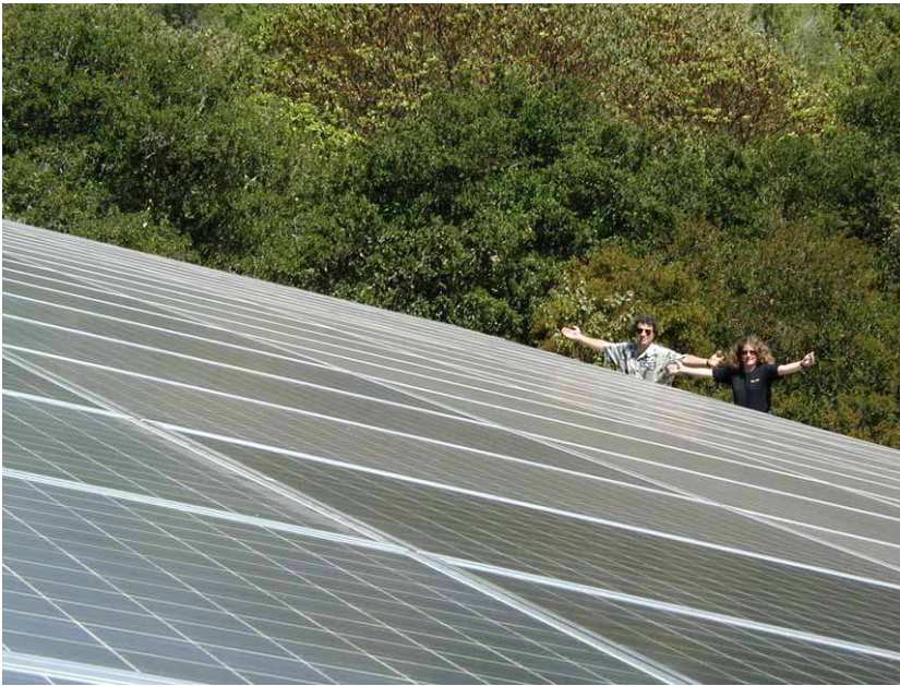
FIGURE 6.6. Deux guerriers du solaire jouissant de leur système photovoltaïque, qui alimente leurs voitures électriques et leur maison. L'ensemble des 120 panneaux (chacun fournissant 300 W et couvrant 2,2 m 2 ) couvre une surface de 268 m 2 , et délivre en sortie une puissance-crête de 30,5 kW (en tenant compte des pertes dues à la conversion du courant continu en courant alternatif) et une production moyenne — en Californie, près de Santa Cruz — de 5 kW (19 W/m 2 ). Photo aimablement fournie par Kenneth Adelman. www.solarwarrior.com
