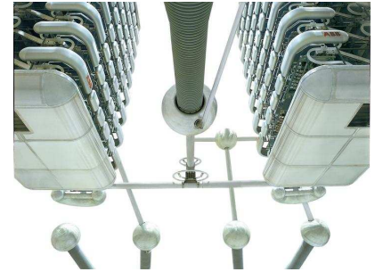
FIGURE 25.13. Un système électrique haute tension en courant continu (HTCC) en Chine. Photo : ABB.
