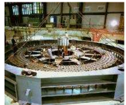
FIGURE 26.15. Un des deux volants d'inertie au centre de recherche sur la fusion de Culham, en construction. Photo : EFDA-JET. www.jet.efda.org .
