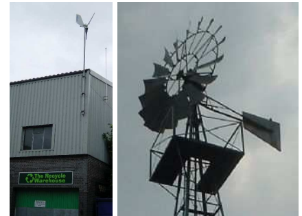
FIGURE B.9. Une micro-turbine Ampair de « 600 W ». La puissance moyenne générée par cette micro-turbine installée à Leamington Spa est de 0,037 kWh par jour (1,5 W).
