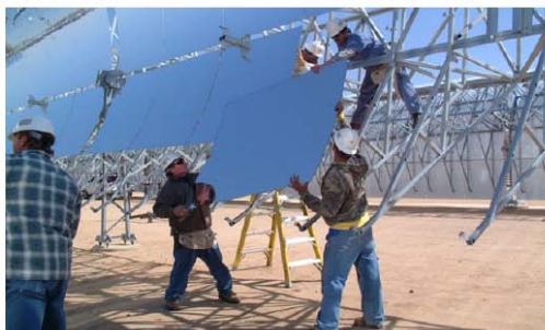
Figure 8. Andasol : une centrale solaire de « 100 MW » en cours de construction en Espagne. L'énergie thermique produite en excès pendant le jour sera stockée dans des réservoirs de sel liquide pendant au moins sept heures, permettant une fourniture d'électricité continue et stable au réseau. La puissance par unité de surface sera 10 W/m 2 . Photo: IEA SolarPACES.
